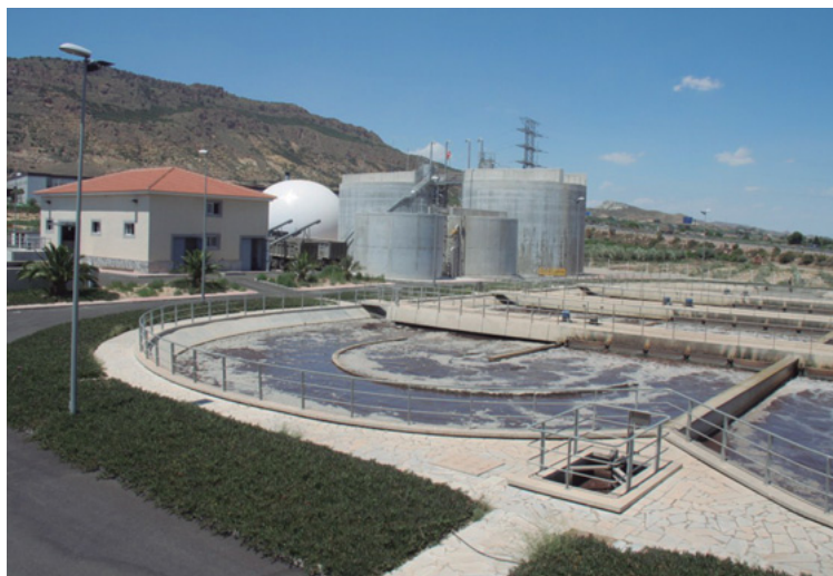
Foto: Veolia. Estación depuradora de aguas residuales en una empresa de alimentación.
