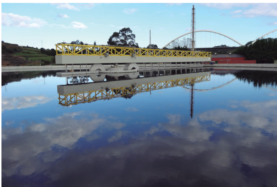
Foto: Veolia. Decantador secundario.
